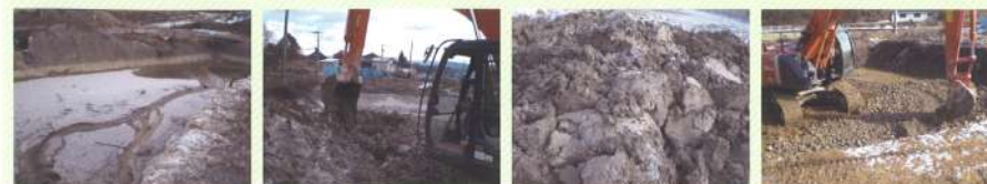
沈砂池の 高含水泥土含水比110% カタツムリの投入攪拌 混合攪拌後搬出 搬出後の敷き均し
